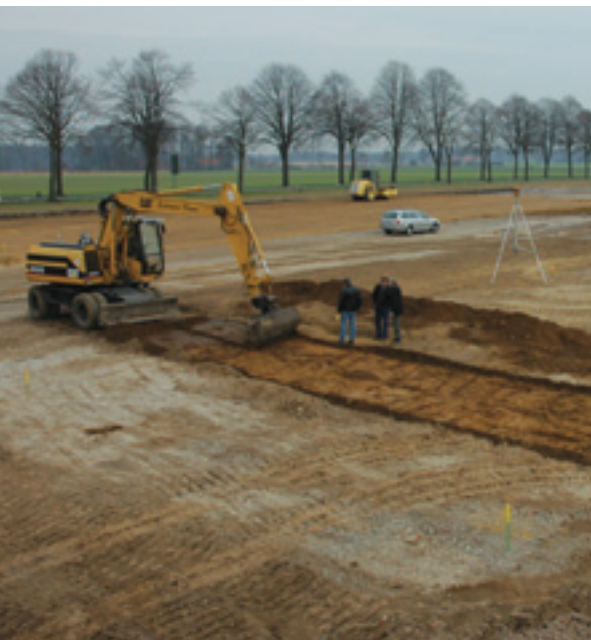
Abb. 2: Abtragen des Bodens im direkten Umfeld des Anhängers mit Hilfe eines Baggers.
