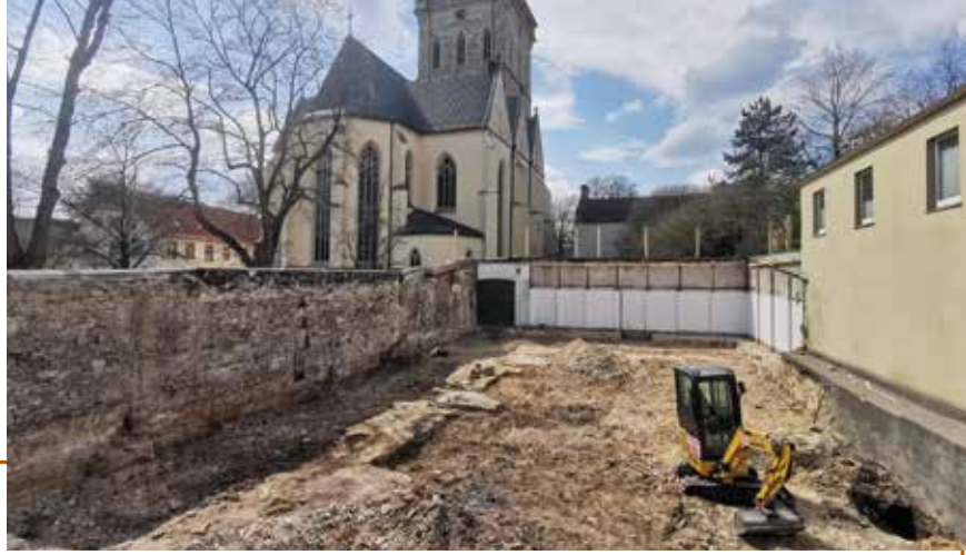
Abb. 1: Blick von Osten in den „Kirchenraum“ der jüngeren Kirche mit der teilweise erhaltenen Südwand. Links der Mitte kommen die älteren Fundamente zum Vorschein. Im Hintergrund St. Katharinen. (Foto: Stadt- und Kreisarchäologie Osnabrück)
